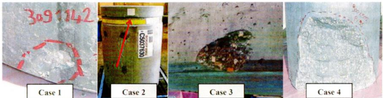
図4．コンクリート容器における不適合つながる損傷事例。
